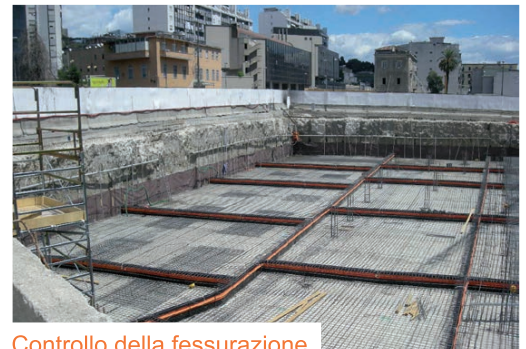
Controllo della fessurazione
