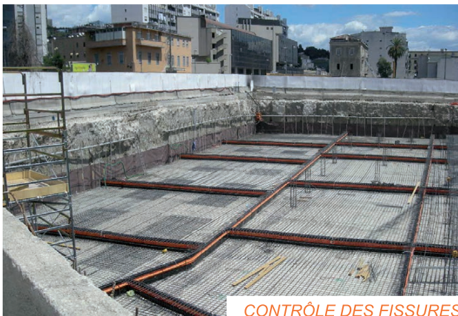
CONTRÔLE DES FISSURES
