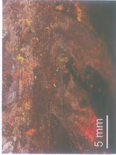
Forte corrosione dell'armatura nella parte immersa direttamente nella resina
